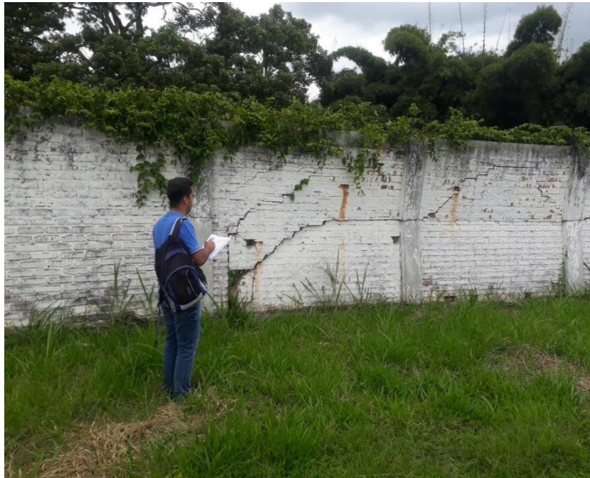
IMAGEN 10: Registro fisura de los muros
