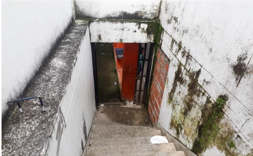
IMAGEN 8: Deterioro en puerta de ingreso
