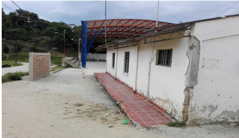
IMAGEN 2: Prueba de la falta de muro colindante Fuente: Soporte fotográfico del autor
