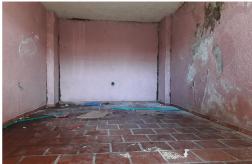
IMAGEN 7: Humedad en los pañetes
