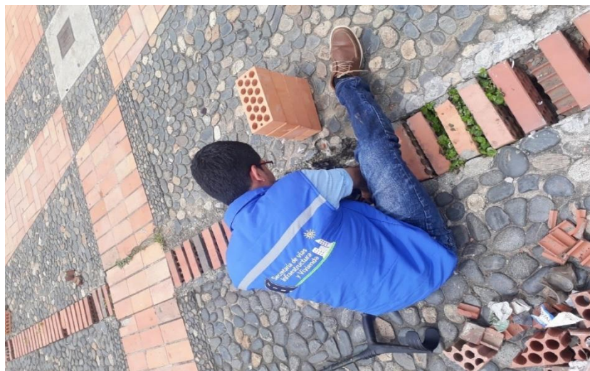
IMAGEN 5:Deterioro del drenaje del canal
