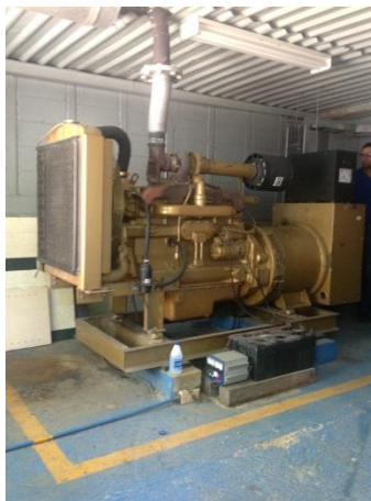
Ilustración 19. Planta eléctrica tomada en la clínica bolivariana
