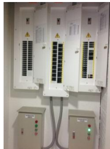
Ilustración 26 Tablero de distribución, tomado Clínica Bolivariana
