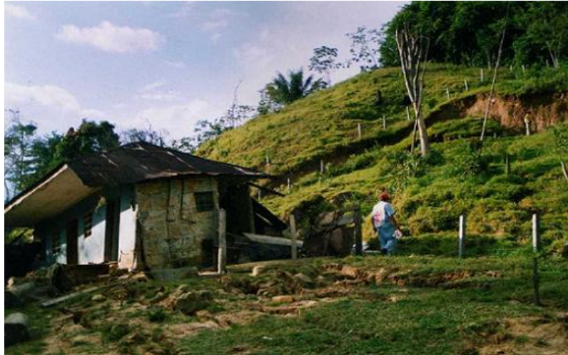
Tomada de: "Informe Tauramena", Ingeominas. Bogotá, Octubre de 1995. Figura 19. Casanare 19 de Enero de 1995 – Vivienda con Daños graves.
