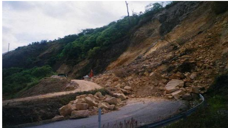
Tomada de: "Informe Tauramena", Ingeominas. Bogotá, Octubre de 1995. Figura 20. Casanare 19 de Enero de 1995 – Desprendimiento de Rocas vía Monterrey y Cansaré.
