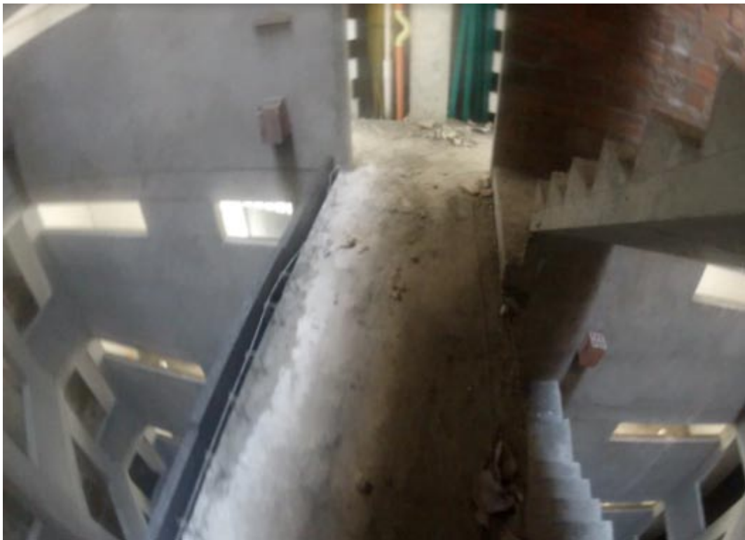
Ilustración 1. Carencia de seguridad A1
