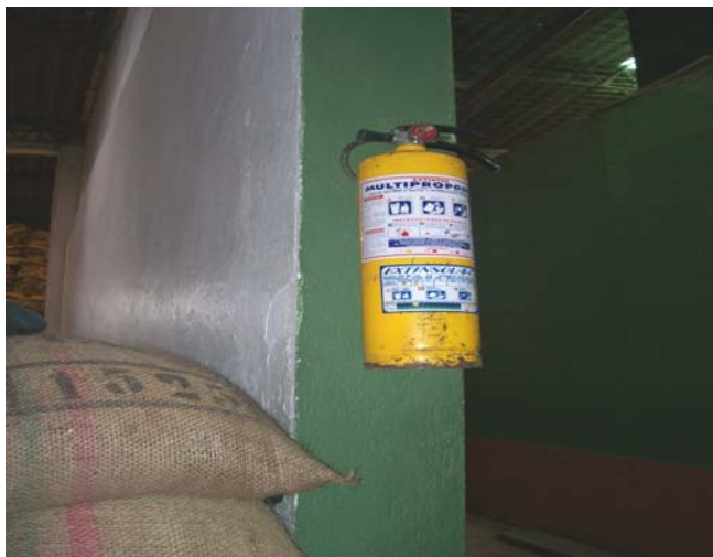
Figura 13. Extintores sin demarcación.
