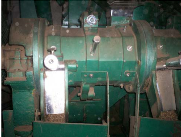
Figura 16. Maquinaria en uso sin hojas de instrucciones y sin mantenimiento.
