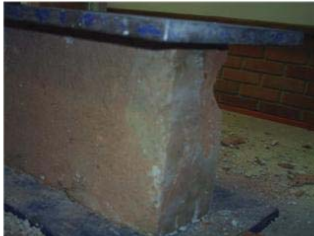
Figura 29. Mal estado de las unidades utilizadas.
