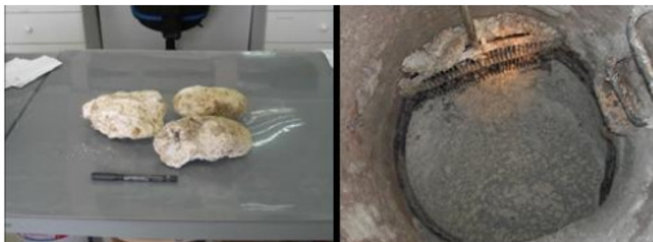
Figura 12. Izquierda, bolas de grasa; derecha, obstrucción de un colector con grasas
